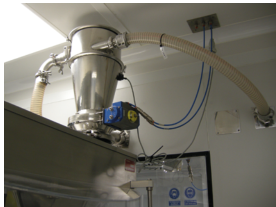
Scarico del prodotto miscelato
